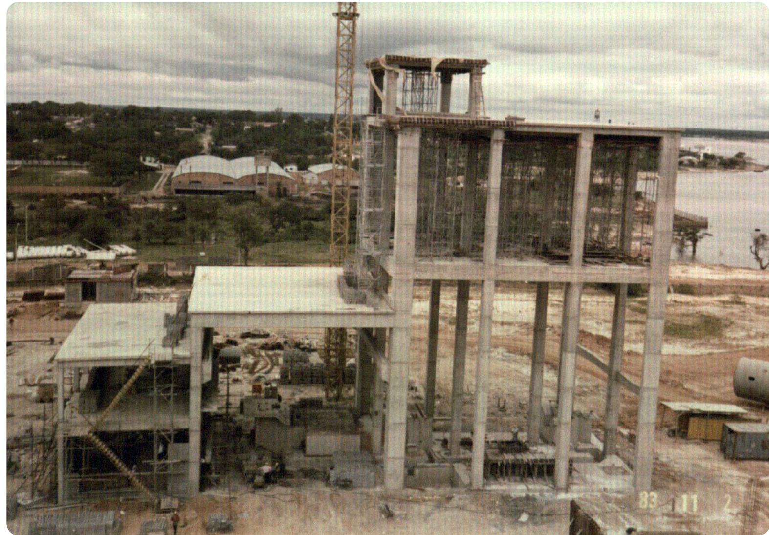
Construcción de la Estructura para las instalaciones del Molino 1 Fábrica Villeta Año 1983
